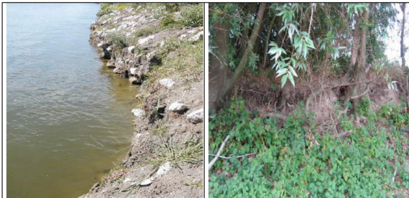
Figure 2.20 – a – Erosion d'une digue non protégée pourtant constituée de matériau contenant des éléments pierreux ; b – L'érosion du talus est ici ralentie par les racines d'arbres mais ces derniers sont ainsi fragilisés en cas de chute par le vent le départ de la souche constituera une « encoche » dangereuse pour la digue
